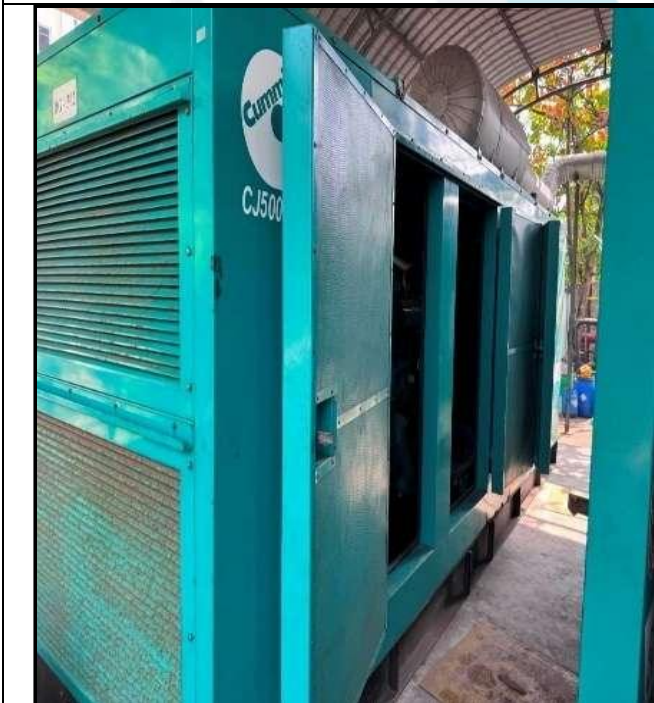
500 KVA DG Set
