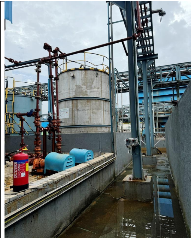
SS Tank- 40 KL
