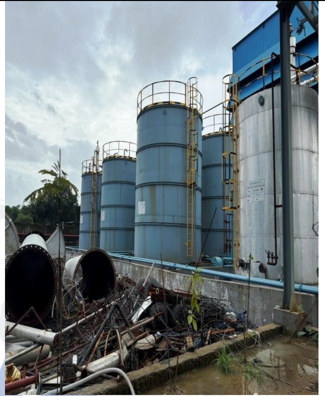
M.S Tank- 100 KL- 2 Nos. & 150 KL
